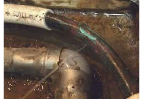
某現場の劣化した配管写真
